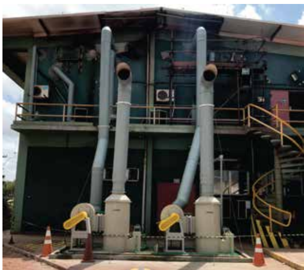
Lavadores de Gases
