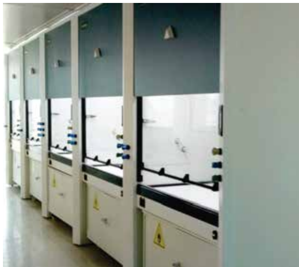
Capelas com VAV, sensor de presença e guilhotina automática
